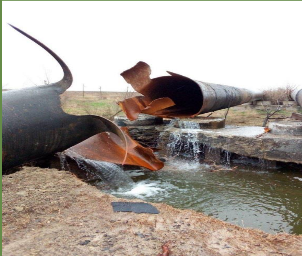
Пошкоджений водогін «Дніпро-Миколаїв» на території Херсонської області, 2022 р.
